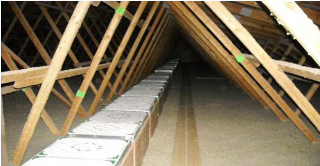
Foto 1: Filtros instalados en áticos de granjas en Norte América (ventilación forzada negativa). Cortesía de Kent Unke (Biosecure Aire Inc.)
