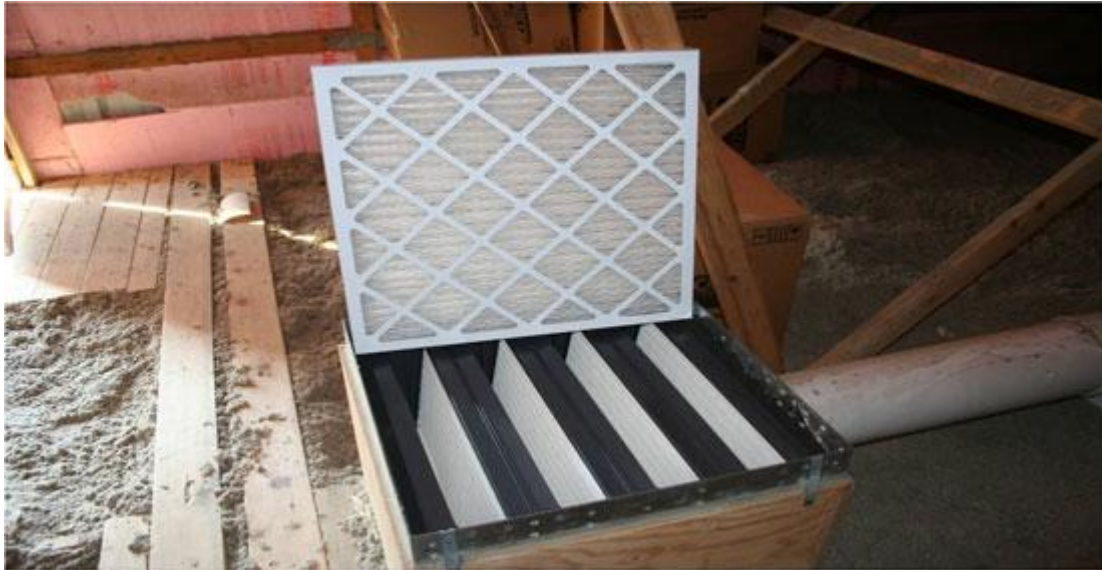
Foto 2: Filtros HEPA en ático. Cortesía de Kent Unke (Biosecure Aire Inc.)
